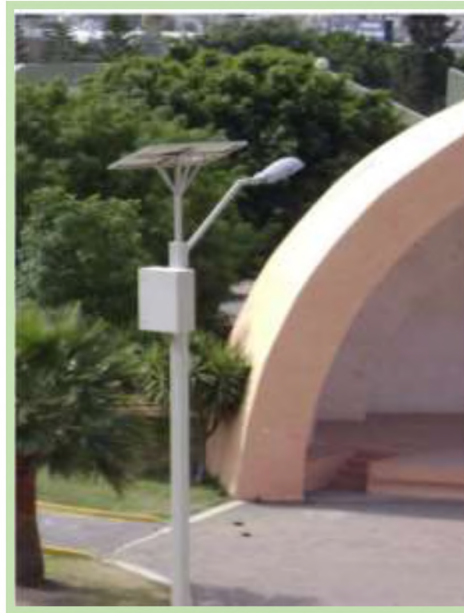
Imagen 3. Luminaria Solar Autónoma de un Panel Solar Fotovoltaico.
